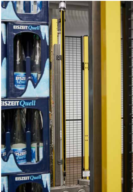
Leuze Sicherheits-Lichtvorhänge MLC 530 SPG gewährleisten die Sicherheit von Mensch und Maschine im Bereich des Be- und Entladens von Paletten.
