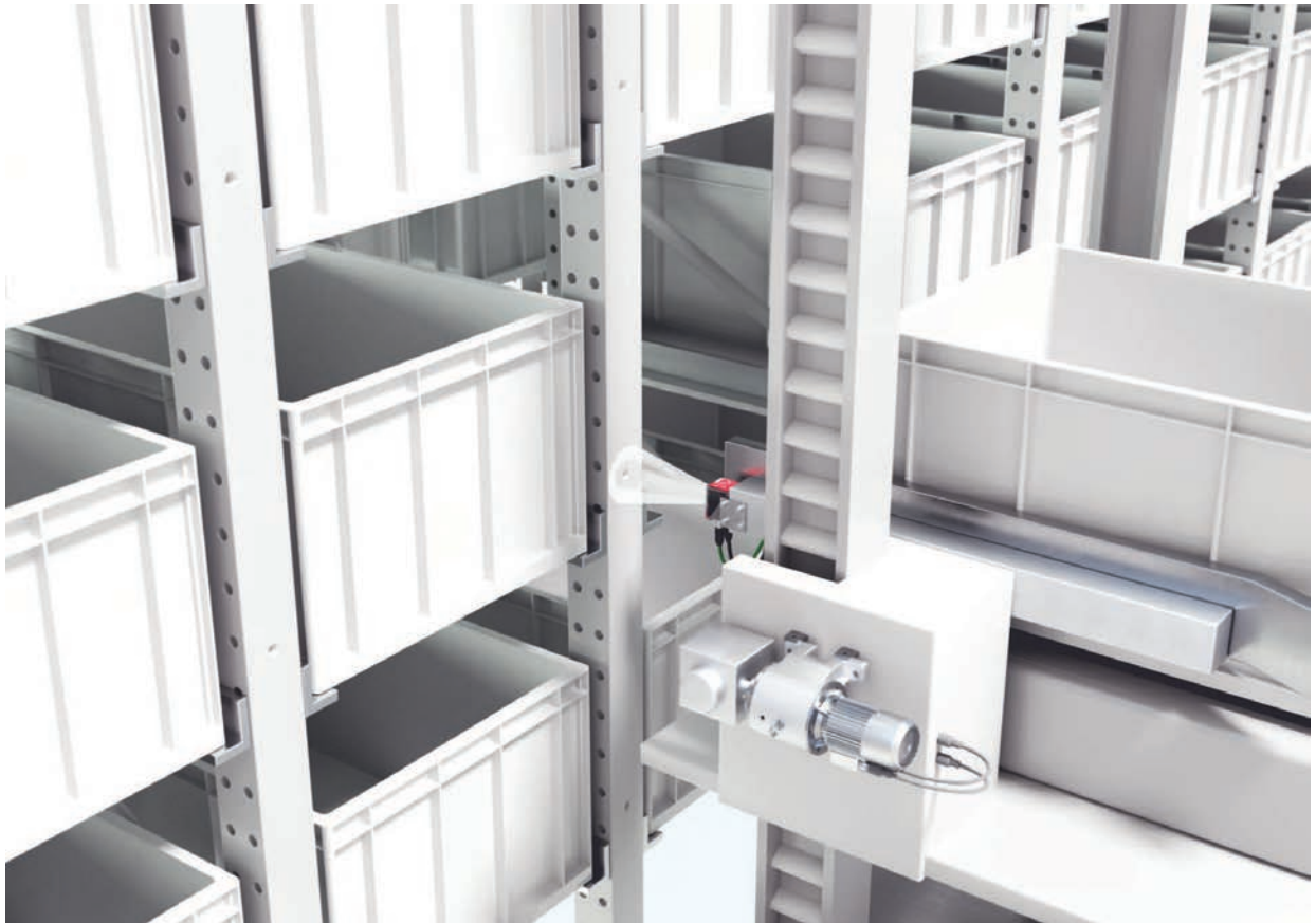
Fig. 5.2: Positionnement précis dans les racks dans un entrepôt de stockage de conteneurs de petites pièces
