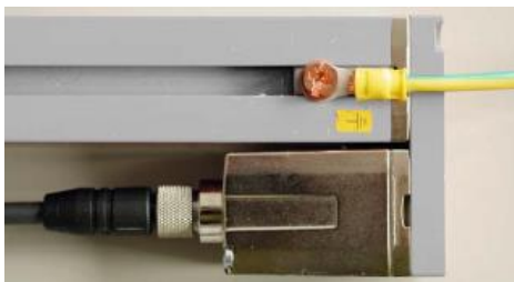
Abbildung 26: Auflegen des Erdpotenzials am Lichtvorhanggehäuse
